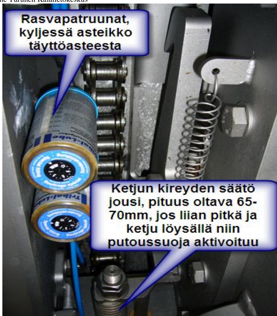
Kuva kaatolaitteen ketjusuojan takaa
